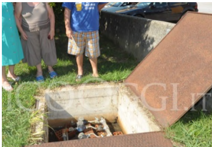
Figura 4 contatori in pozzetto con lamiera di copertura
