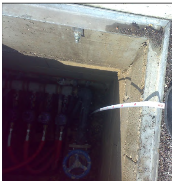
Figura 6 pozzetti profondi con più contatori
