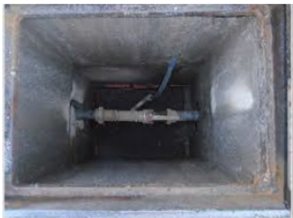
Figura 5 pozzetti profondi ed angusti
